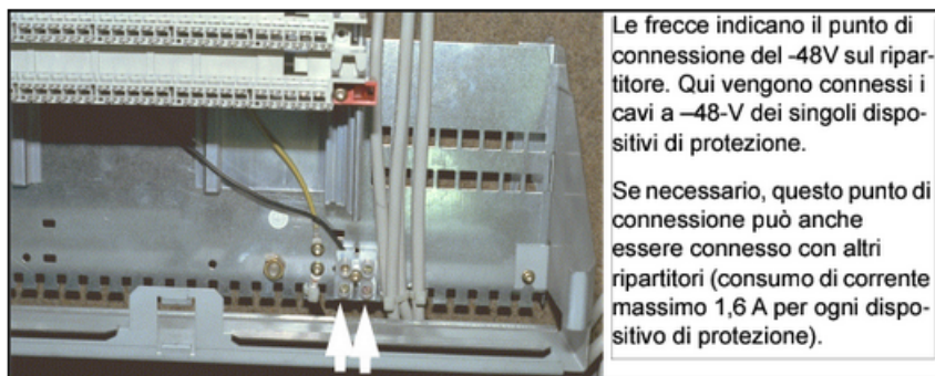
Figure 130: Punto di connessione del ripartitore a -48 V
