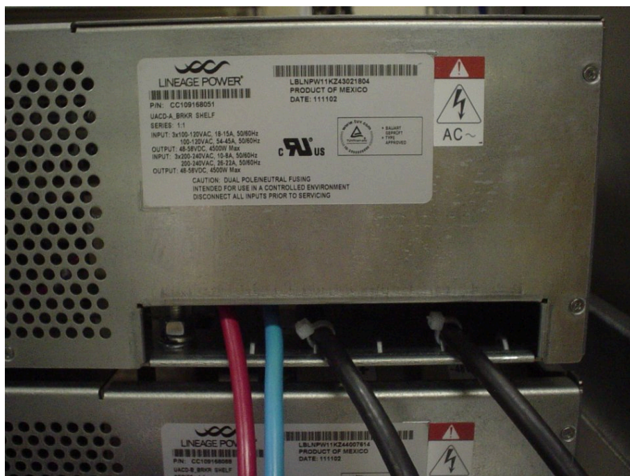
Figure 151: Batteria e presa da -48 V
