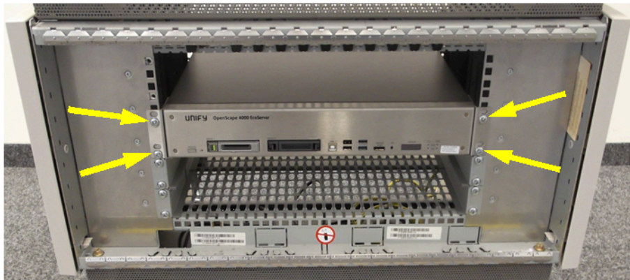
Figure 43: Installazione di EcoServer
