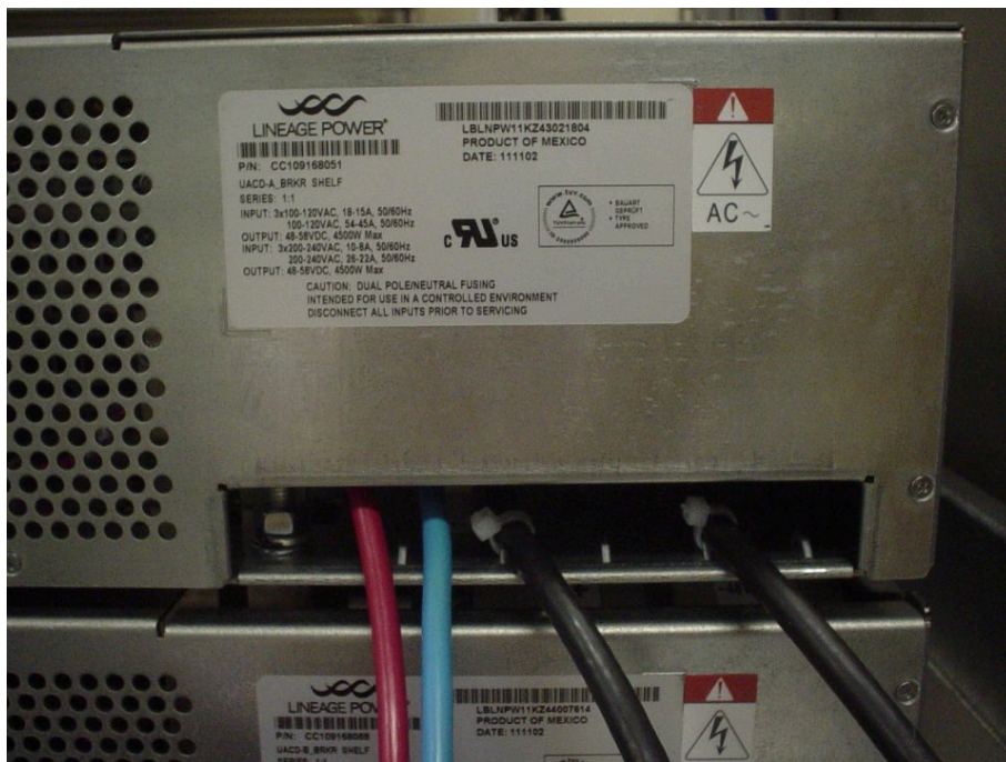
Figure 151: Batteria e presa da -48 V
