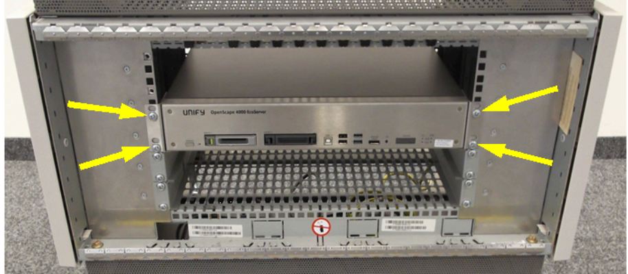
Figure 43: Installazione di EcoServer
